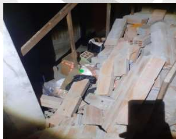
01 Vivienda destruida en distrito de Bella Unión.
