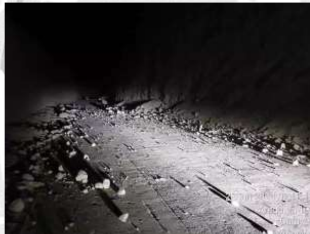
Afectación en el distrito de Jaqui
